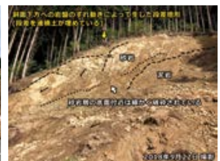
写真2 愛媛県西予市宇和町下川地区で発生した深層崩壊。
