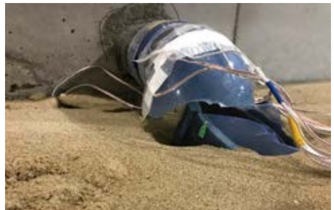
図2 排水管の損傷
