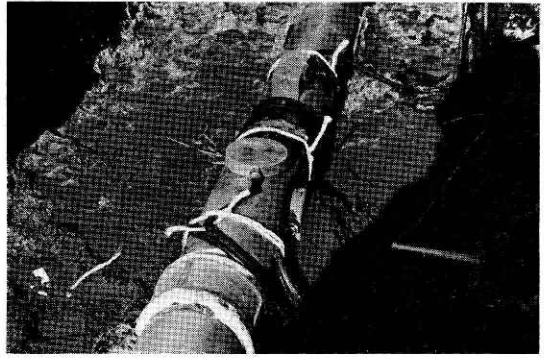
写真 2 センサー取付状況 Picture 2 Setting of sensors
